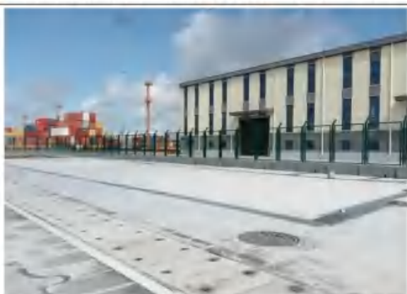
事故应急池（地下式）
