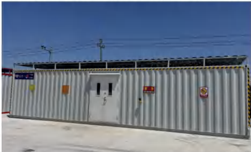
图 9.2-1 危废暂存库现场照片
