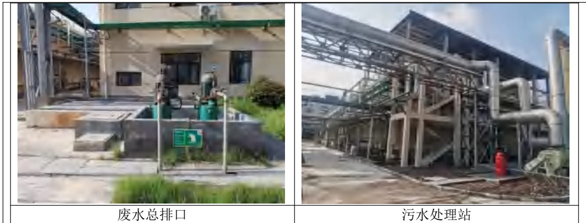
图 3-3 污水站及废水总排口图
