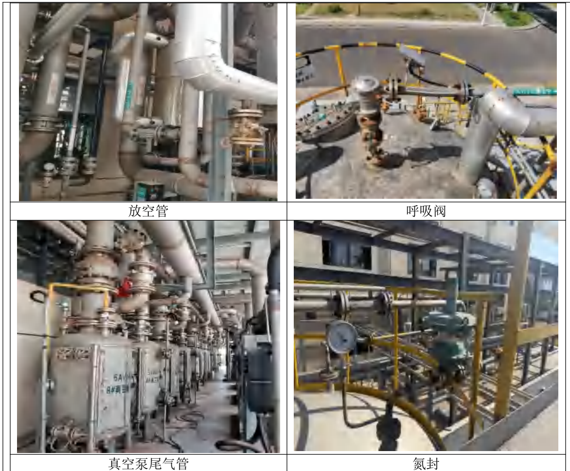
图 3-5 各类废气收集措施照片
