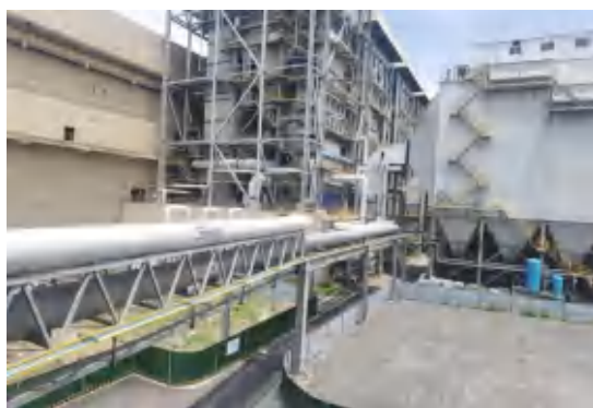
废气输送管道
