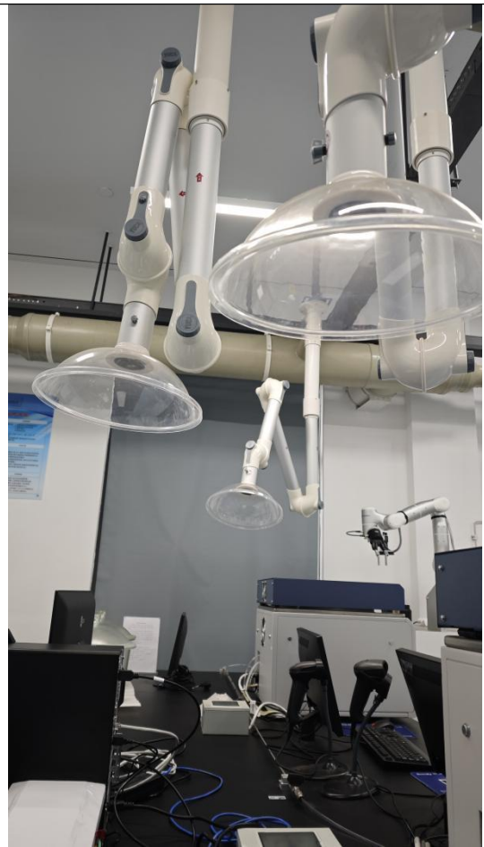
实验室内部废气收集系统
