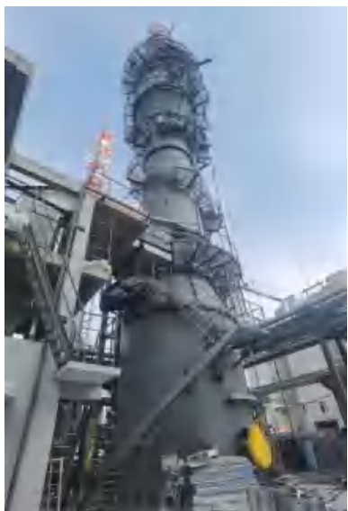
石灰石-石膏湿法脱酸系统+湿电除尘器+ 塔顶烟囱
