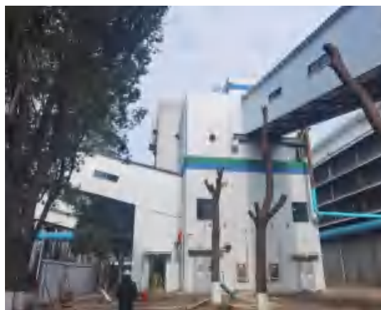
污泥输送系统
