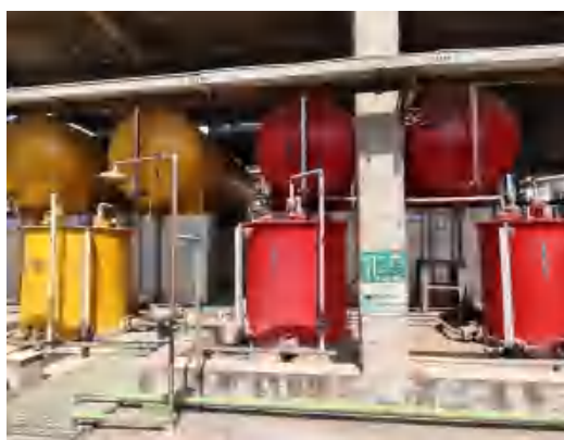
酸碱罐及围堰（依托现有）
