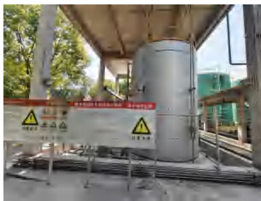
氨水罐及围堰（依托现有）
