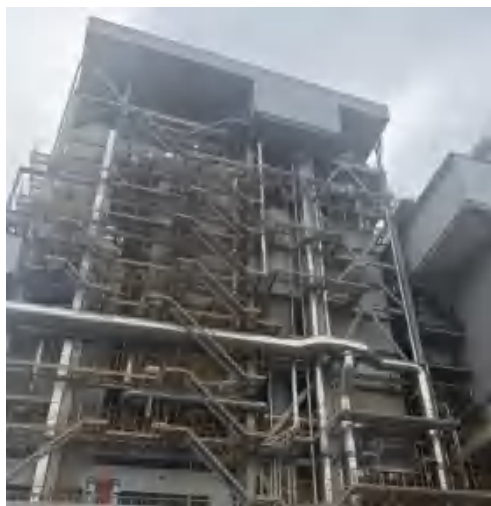
污泥焚烧循环流化床锅炉（一用一备）
