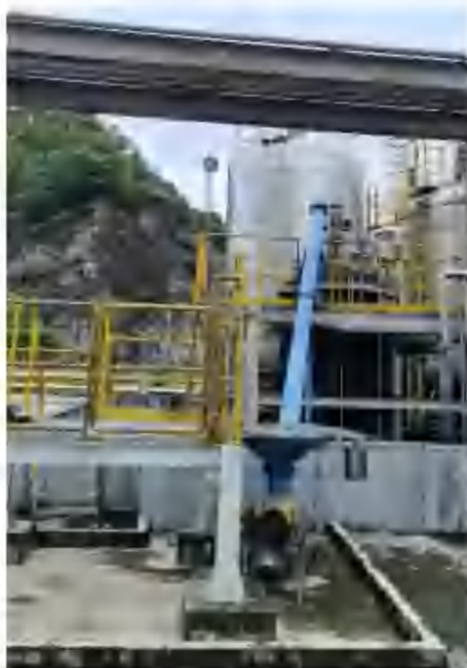
脱硝尿素投料系统
