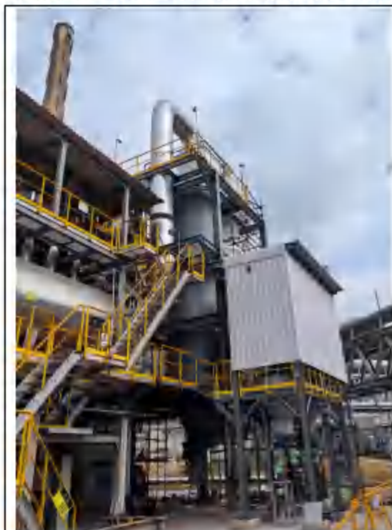
急冷塔及喷粉加药装置
