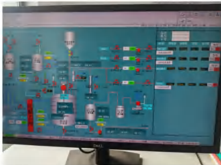
(DCS 控制系统)
