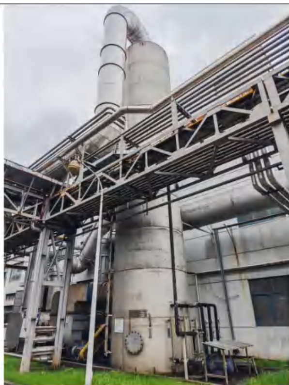
聚氨酯低浓废气处理喷淋塔
