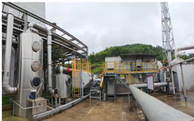
聚氨酯高浓废气喷淋+RTO 装置
