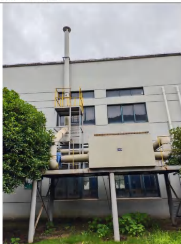
危废库废气处理设施
