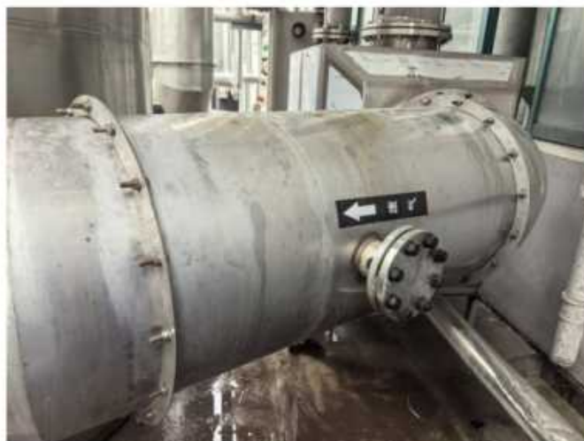
图 7.1-3 DA008 废气处理设施进口管道
