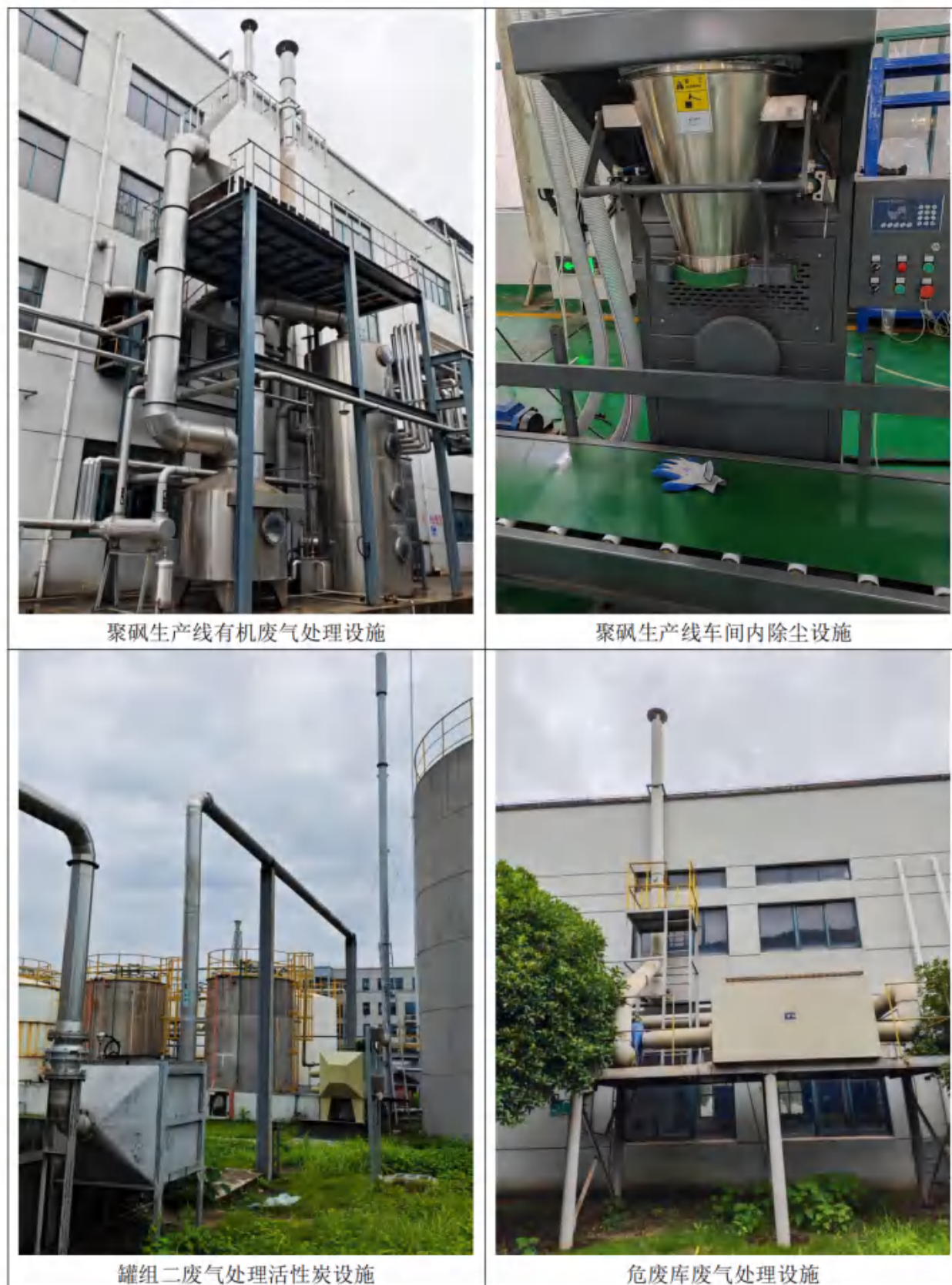
图 4.1-5 现场废气处理设施照片
