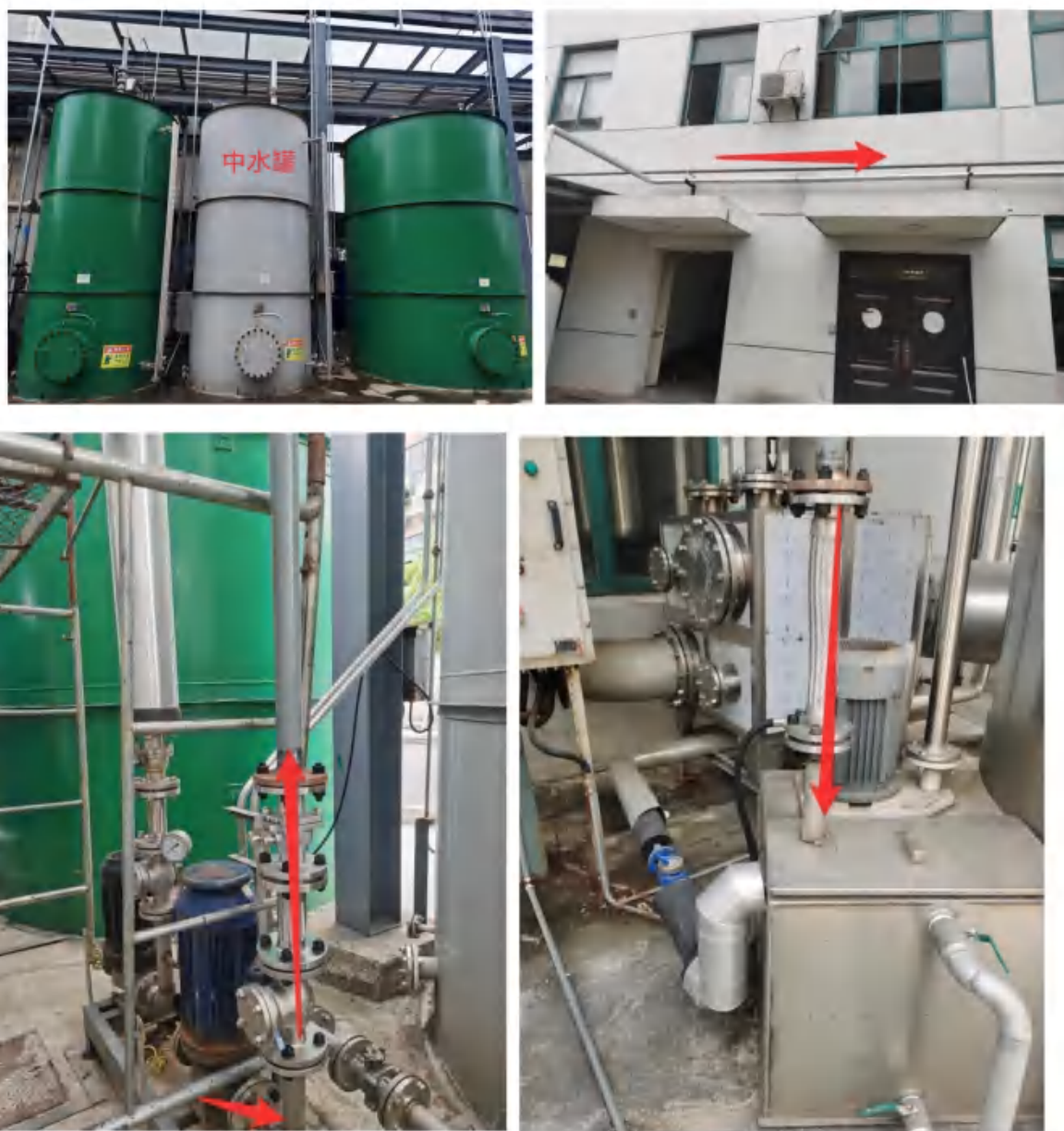
图 4.2-2 “以新带老”措施中水回用收集罐和管道照片
